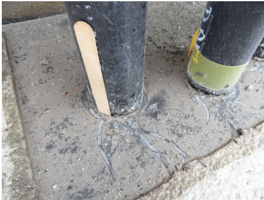
Foto: Voorbeeld van een niet-afgedichte doorvoer.
