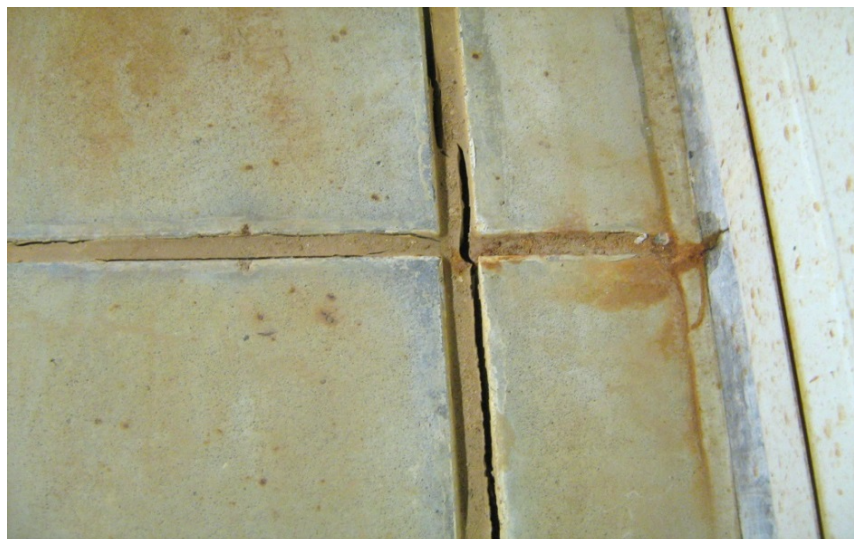
Foto: Beschadigde kitvoeg.
