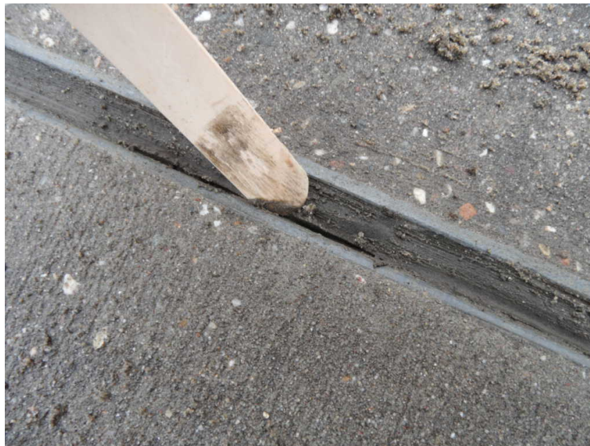
Foto: Afdichting is onthecht.
